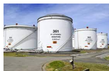
Réservoir aérien fixe
